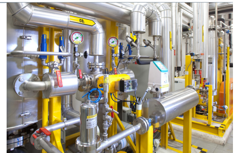
Durchflussmesser, montiert auf Rahmen mit Aktivkohlefilter/Trockner
