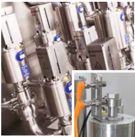
Prozessventile mit Näherungsinitiatoren und zusätzlichen Fingerschutzvorrichtungen
